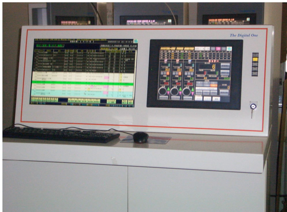
メイン制御盤
