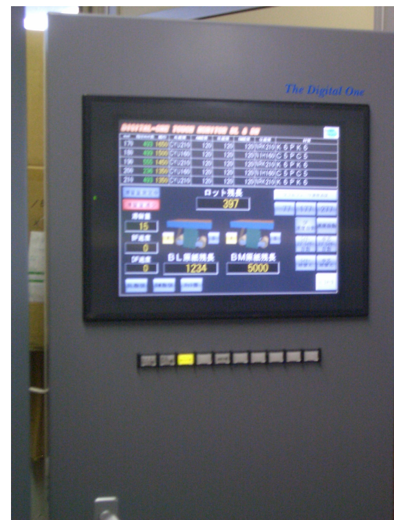
シングルファン制御盤
